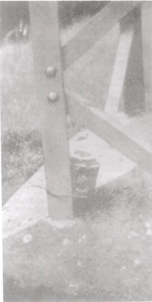
Bombenanschlag auf die Starkstromleitung der „Newag“ in Pottenstein am 26. Juni 1933.
